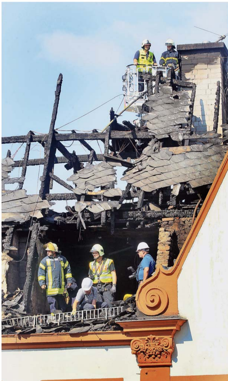
Etliche Feuerwehrkräfte sind noch im Einsatz, nachdem die Haupt-Löscharbeiten abgeschlossen sind. Sie sichern das Gebäude. FOTOS (2): FRIEDEMANN VETTER
